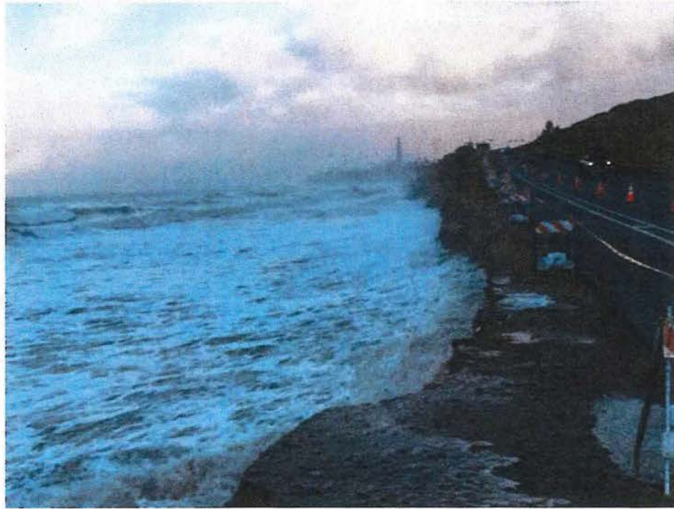
Photo 7. Erosion at Las Encinas Bridge
